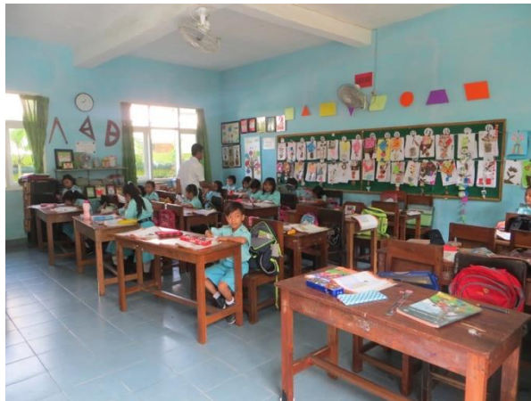
Gambar 4.12 Elemen Falling Hazard berupa kipas angin di langit-langit kelas SD Negeri Ploso
