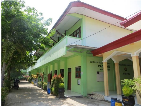
Gambar 4.11 Elemen Falling Hazard berupa kanopi dari asbes di SD Negeri Pacitan
