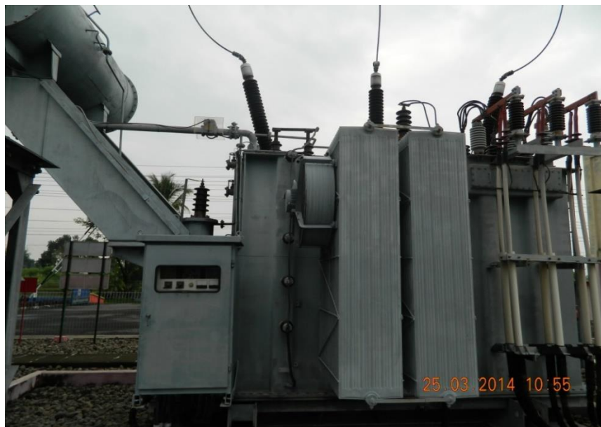
Gambar 2. 1 Bentuk fisik trafo daya (sumber: Foto Trafo di Gardu Induk Medari)
