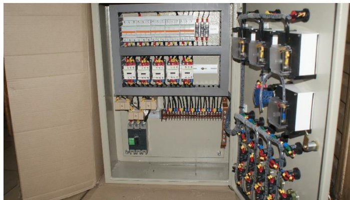
Gambar 2.7 Panel listrik tegangan menengah
