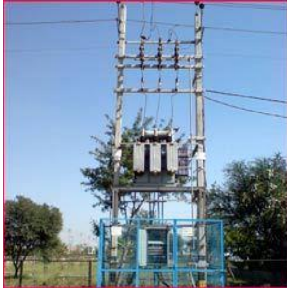
Gambar 2.3 Gardu listrik tegangan menengah
