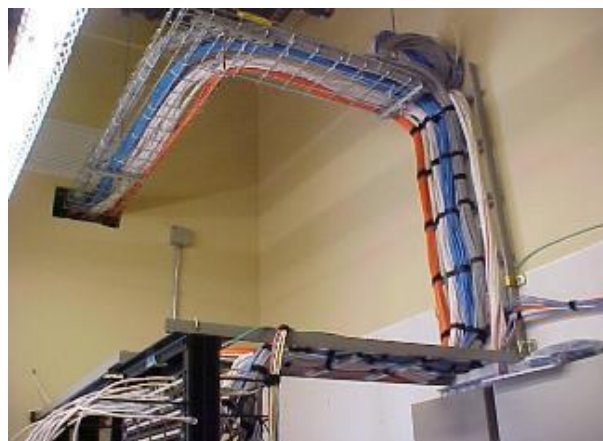
Gambar 2.26 Jalur tray kabel di langit langit bangunan.
