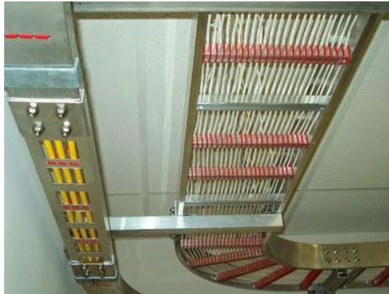
Gambar 2.25 Jalur tray kabel di langit langit bangunan.
