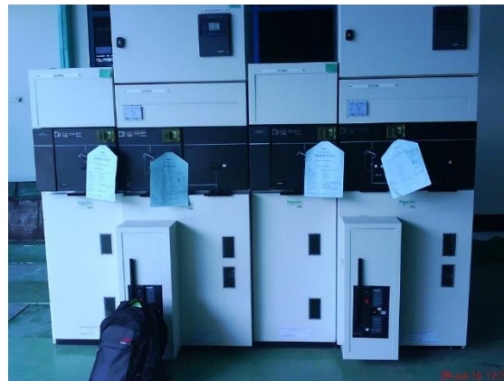
Gambar 2.4 Panel listrik tegangan menengah.
