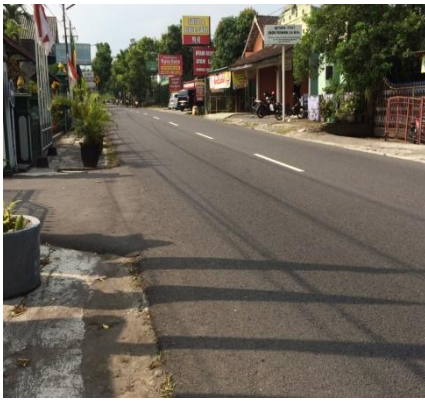
(a) Kondisi Permukaan Jalan
