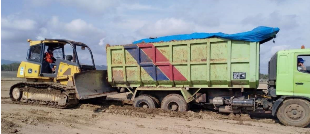
Gambar 4.7 DT sedang didorong bulldozer akibat amblas
