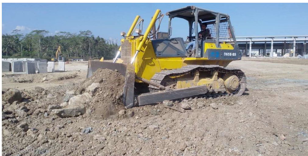
Gambar 4.15 Operator bulldozer masih kurang sadar dalam penggunaan APD
