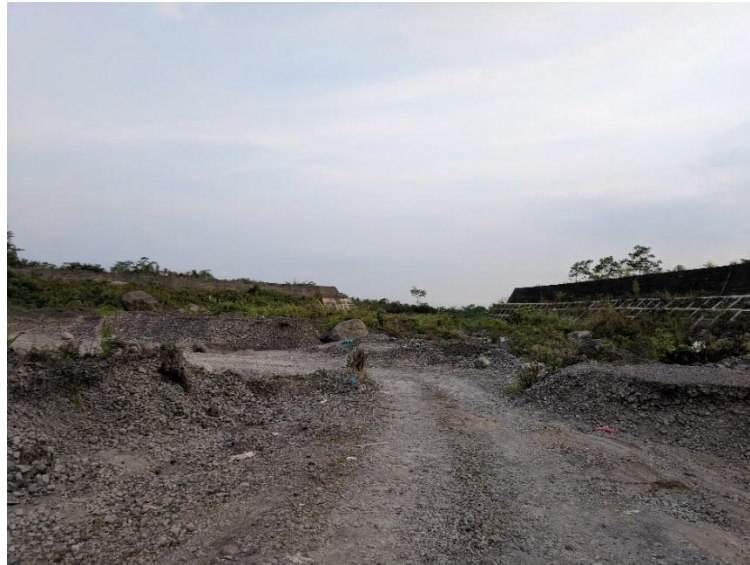
Gambar 4.58 Bangunan kantung pasir
