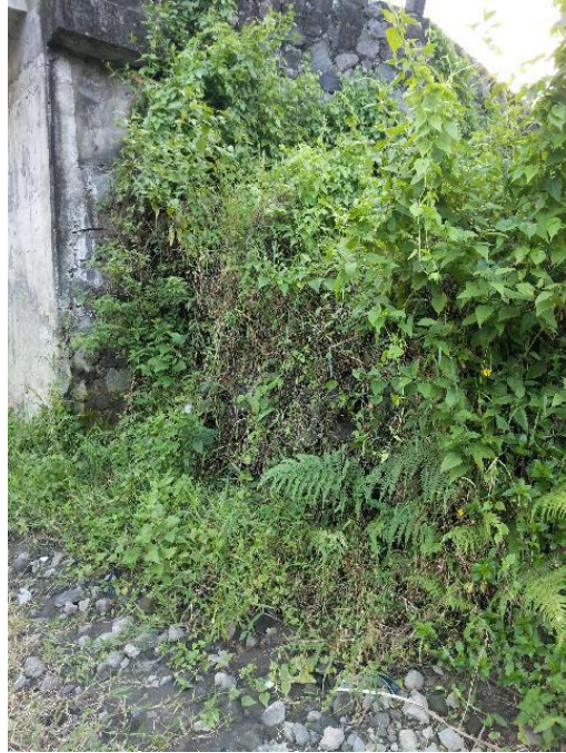
Gambar 4.45 Bronjong yang mengalami sedikit kerusakan
