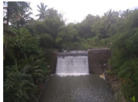
Gambar 16 Kondisi sempadan bagian hilir Sungai Krasak
