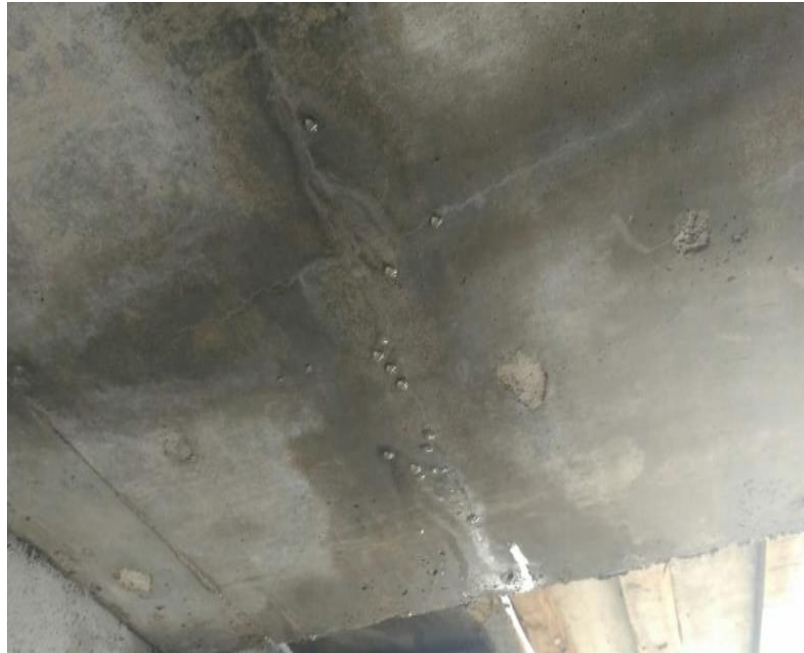
Gambar 4.12 Kebocoran pada area yang belum dilakukan waterproffing
