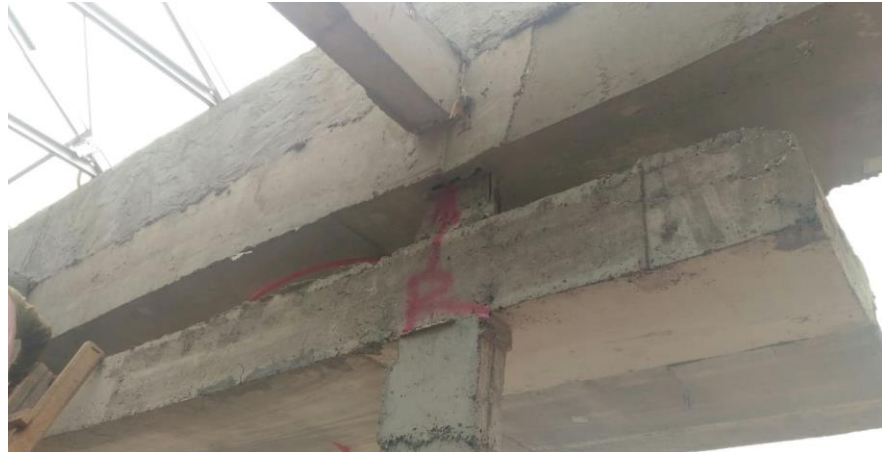
Gambar 4.4 Beton yang menjadi keropos
