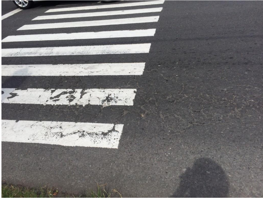
Gambar 1. Kerusakan Retak Kulit Buaya
