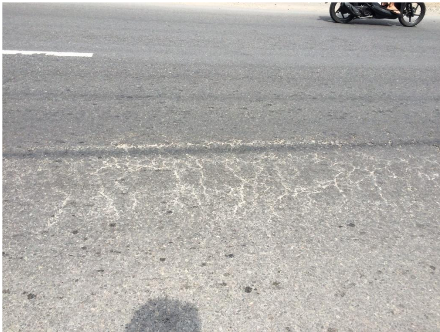
Gambar 2. Kerusakan Retak Kotak-kotak
