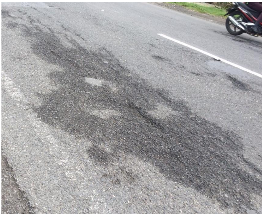
Gambar 6. Kerusakan Retak Memanjang
