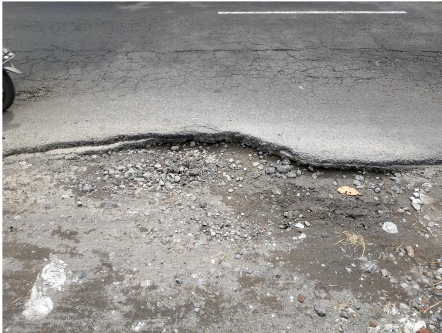
Gambar 5. Kerusakan Retak Pinggir
