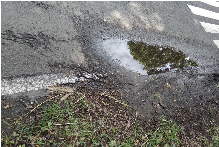
Gambar 3. Kerusakan Pinggir Jalan Turun Vertikal
