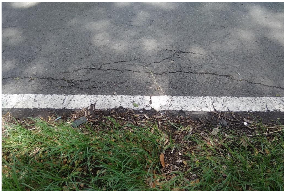
Gambar 4. Kerusakan Retak Pinggir
