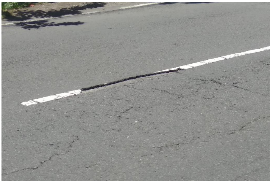
Gambar 6. Kerusakan Retak Memanjang
