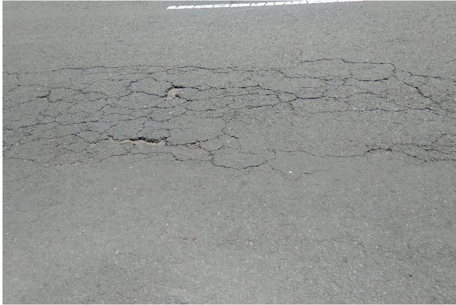
Gambar 1. Kerusakan Retak Kulit Buaya
