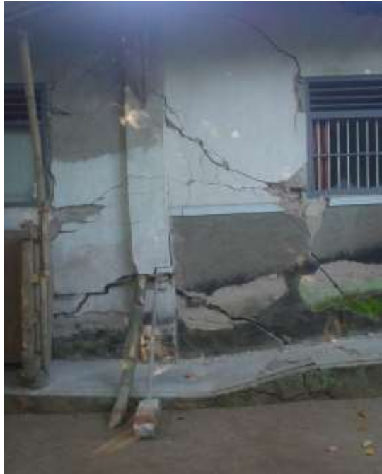
Gambar 1.1 Kerusakan gempa Yogyakarta 2006 ( geomagz.geologi.esdm.go.id )
