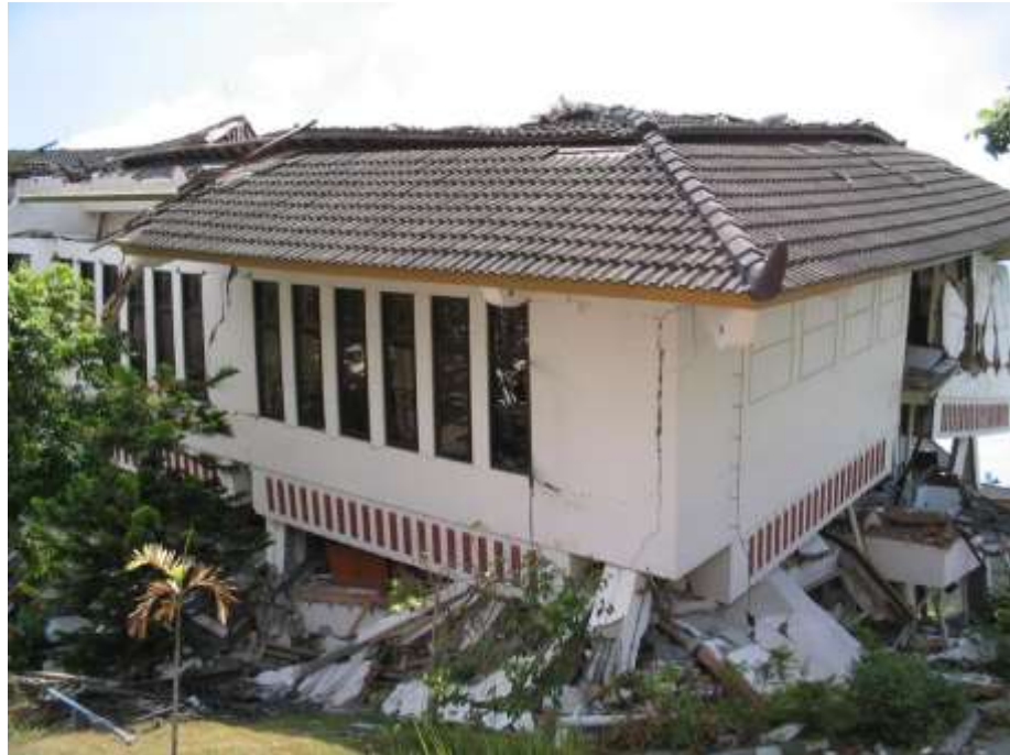
Gambar 1.2 Kerusakan gempa Yogyakarta 2006 ( geomagz.geologi.esdm.go.id )
