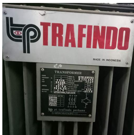
Gambar 4.1 Name plate transformator penyuplai gedung Admisi
