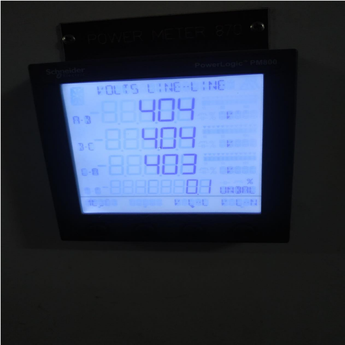
Lampiran 5. Gambar pengambilan data Tegangan Antar Fasa (Volt)
