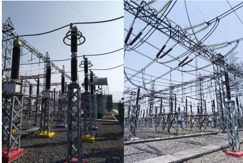
Gambar 4.1. Bay Trafo Gardu Induk 150 kV Pedan
