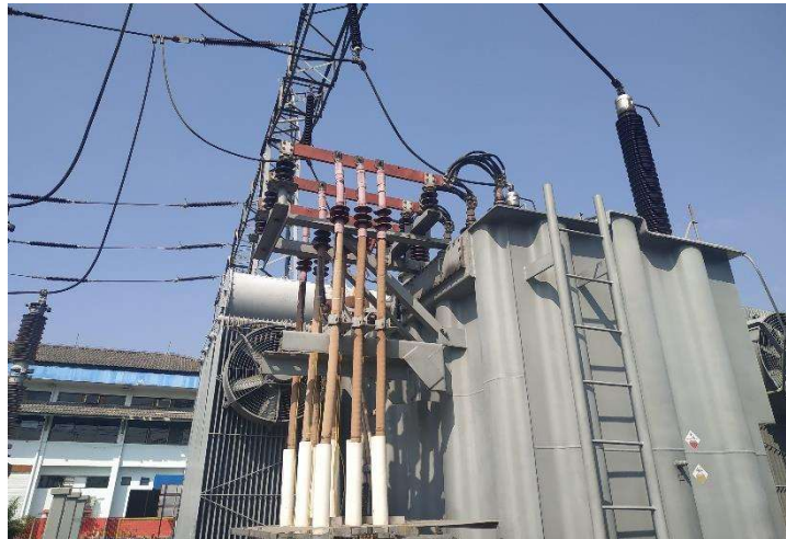
Gambar 4. 1 Trafo Gardu Induk Kentungan
