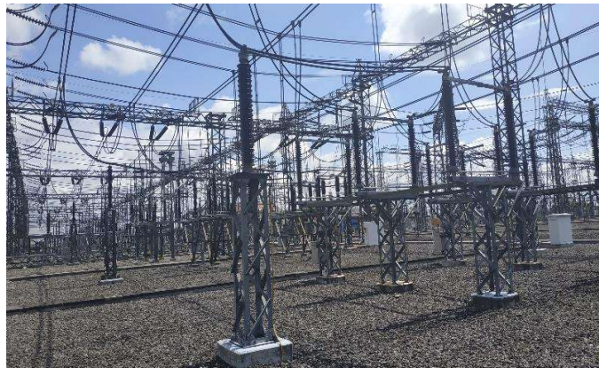
Gambar 2. 1 Switchyard pada Gardu Induk (Sumber: Dokumentasi Pribadi)
