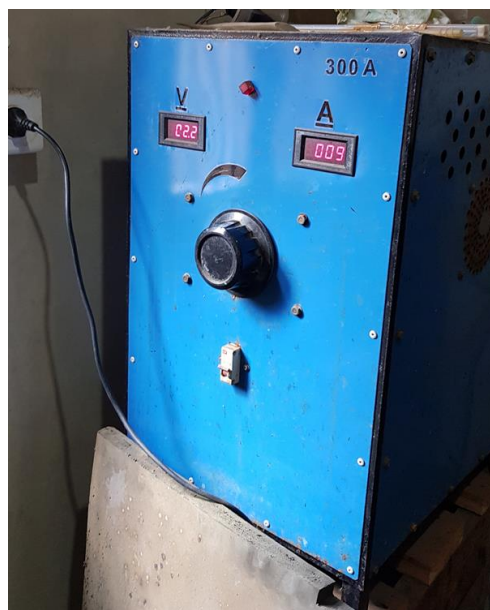
Gambar 3.2 Retrificier /trafo DC
