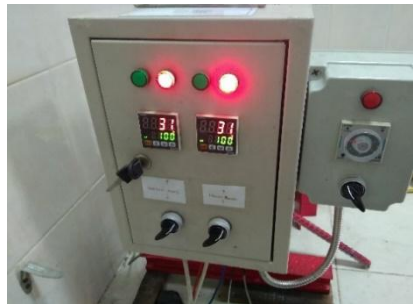
Gambar 3.31 Temperatur pada control Box
