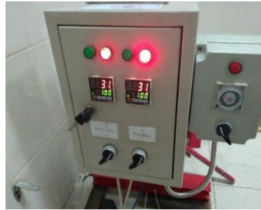
Gambar 3.29 Temperatur pada control Box
