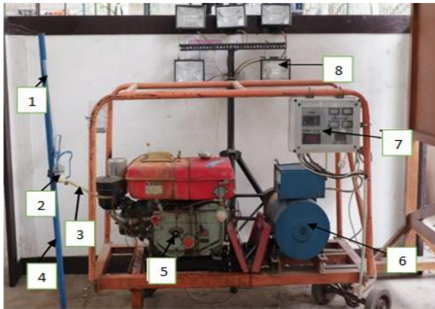
Gambar 3.4 Mesin Diesel dan Alternator
