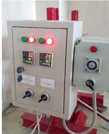
Gambar 3.20 Temperatur pada control box
