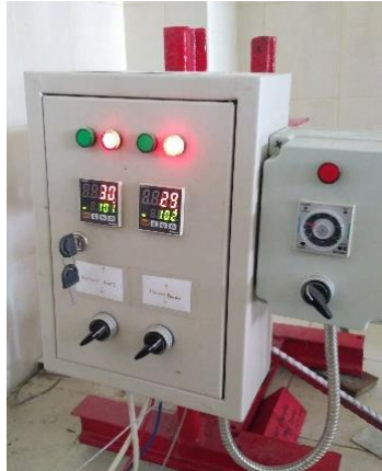
Gambar 3.20 Temperatur pada control box
