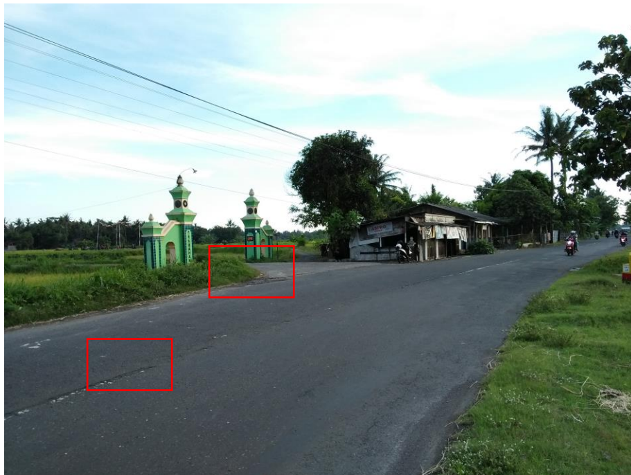
Gambar 4.13 Kondisi ruas jalan dengan garis marka tidak terlihat
