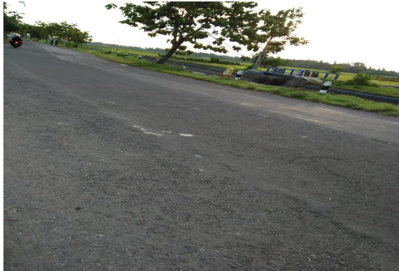
Gambar 4.9 Marka jalan yang tidak terlihat
