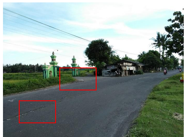
Gambar 4 Kondisi ruas jalan dengan marka tidak terlihat
