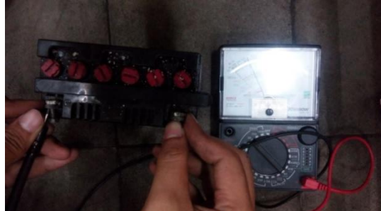
Gambar 3.3 Pemeriksaan tegangan pada baterai
