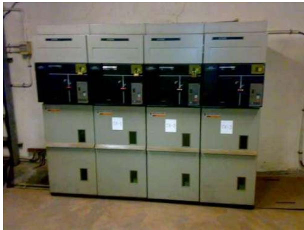
Gambar 2.6. Panel Utama Tegangan Menengah (sumber: http://binateknik.indonetwork.co.id/ )
