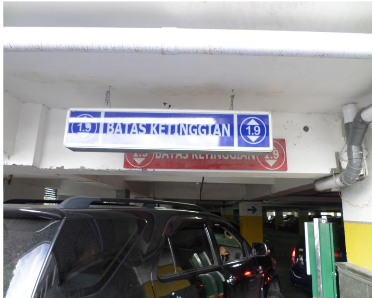
RAMBU BATAS KETINGGIAN DI PINTU MASUK KE AREA PARKIR LANTAI BASEMENT LGM KHUSUS KENDARAAN RODA 4 (EMPAT)
