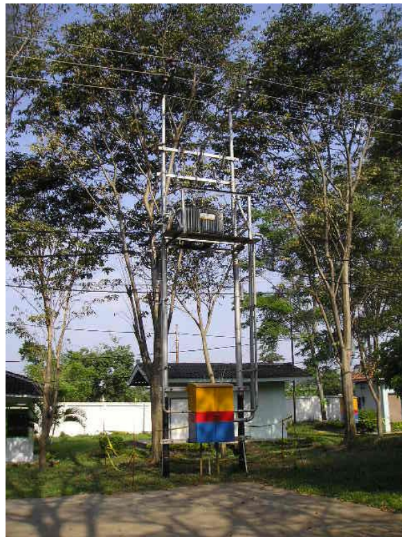
Gambar 2.1. Gardu Tiang PLN lengkap dengan Trafo Outdoor (Sumber: http://dc398.4shared.com/doc/zi2FtjQ_/preview.html )
