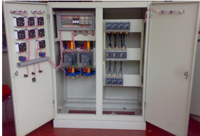
Gambar 2.6. Panel AMF ATS 200kVA dengan Motorized MCCB dan LVMDP (Sumber: http://sentradayaabadi01.blogspot.com/p/amf-ats.html )
