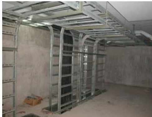
Gambar 2.30. Ladder Kabel di Dinding
