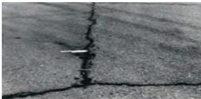
Gambar 3. 17. Retak Sambung ( Joint Reflec Cracking )
