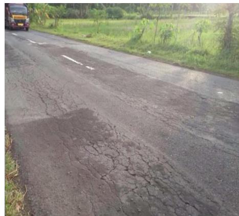
Retak kotak- kotak
