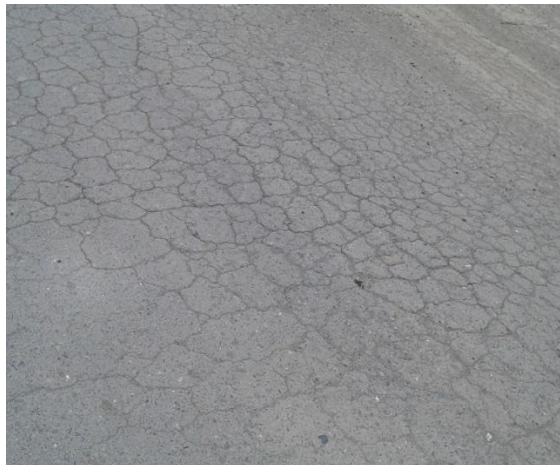
Gambar 3.2 Retak Kulit Buaya ( Aligator Cracking )
