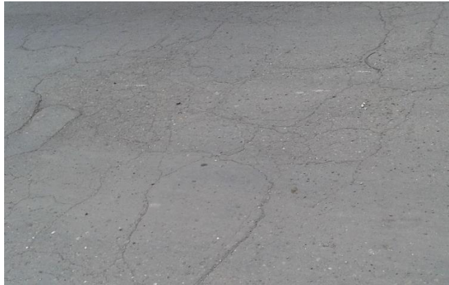
Gambar 3.6 Retak Kotak-kotak ( Block Cracking )
