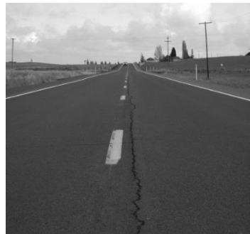
Gambar 3.20 Retak Memanjang/Melintang Sumber : Bina Marga No.03/MN/B/1983
