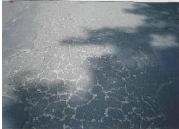
Gambar 3.38 Pelepasan Butir ( Weathering/Raveling )
