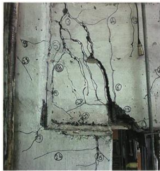
Gambar 2.8 Pola retak Benda uji CIPC (Ertas, 2006)
