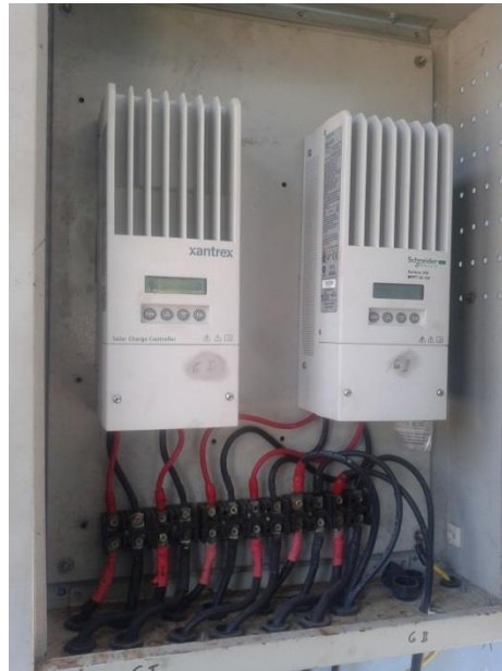
Gambar 4.3. Mppt Yang Terdapat Pada PLTS Sistem 48 V
