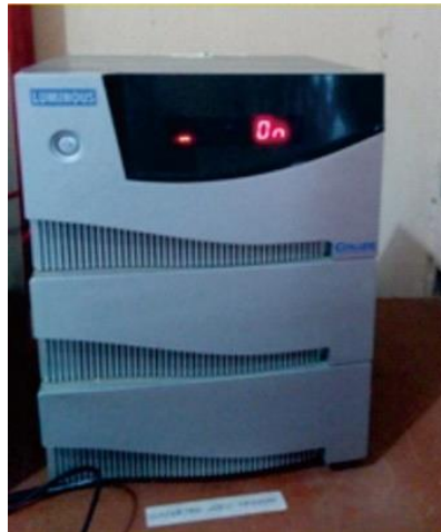
Gambar 4.4. Inverter Yang Di Gunakan Pada PLTS Sistem 48 V
