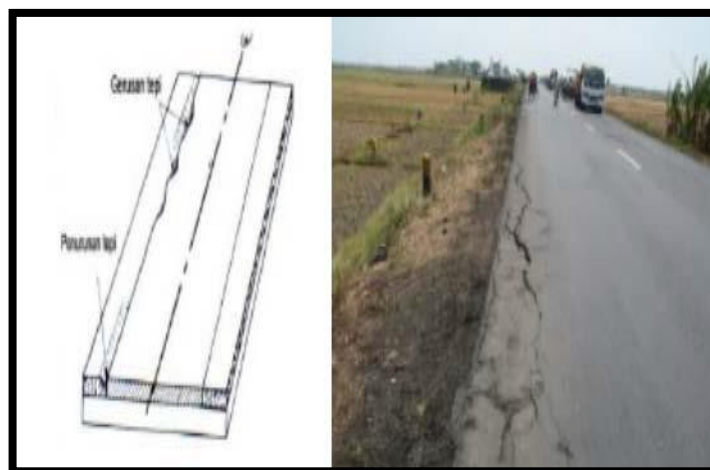
Gambar 3.15 Retak Samping Jalan ( Edge Cracking )
