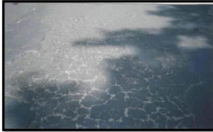
Gambar 3.39 Pelepasan Butir ( Weathering/Raveling )
