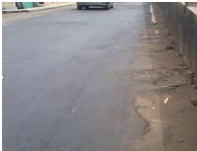
Gambar 2 Kegemukan ( Bleeding ) Sumber : Buku Ajar Pemeliharaan Infrastruktur Transportasi
