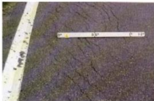
Gambar 16 Retak Patah Slip
