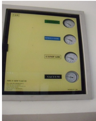
Gambar 4. 23 Instalasi Gas Medik dan Vakum Medik
