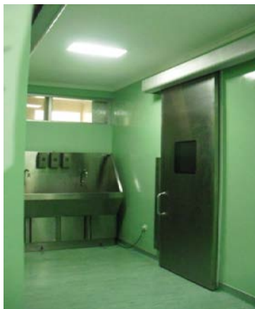
Gambar 4.18 Pintu antara Ruang Scrub-up dengan Ruang Operasi
