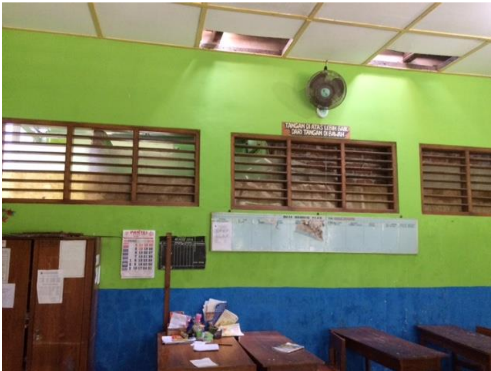
Gambar 1.2. Kondisi Ruang Kelas pencahayaan sementara dengan membongkar plafon dan menggantikan atap genteng dengan atap plastik transparan
