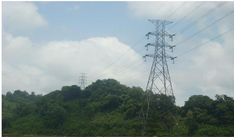
Gambar 2.1. Saluran Udara Tegangan Tinggi (SUTT)
