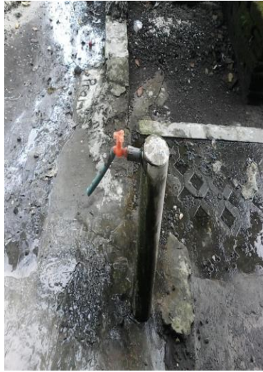
Gambar 4.7 Air kran laboratorium teknologi bahan konstruksi, Universitas Muhammadiyah Yogyakarta
