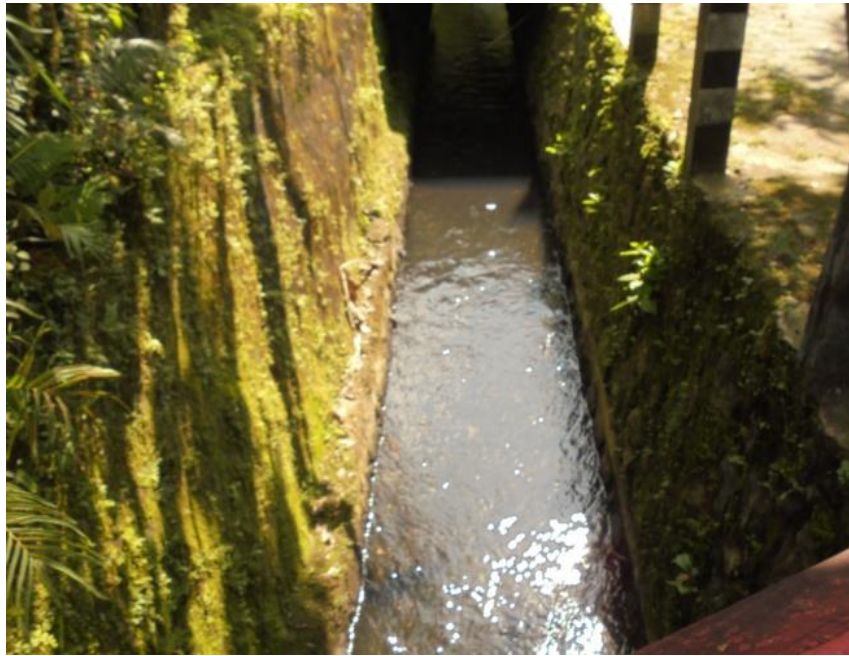
Foto 1. Kondisi Saluran Drainase di Kecamatan Pakem
