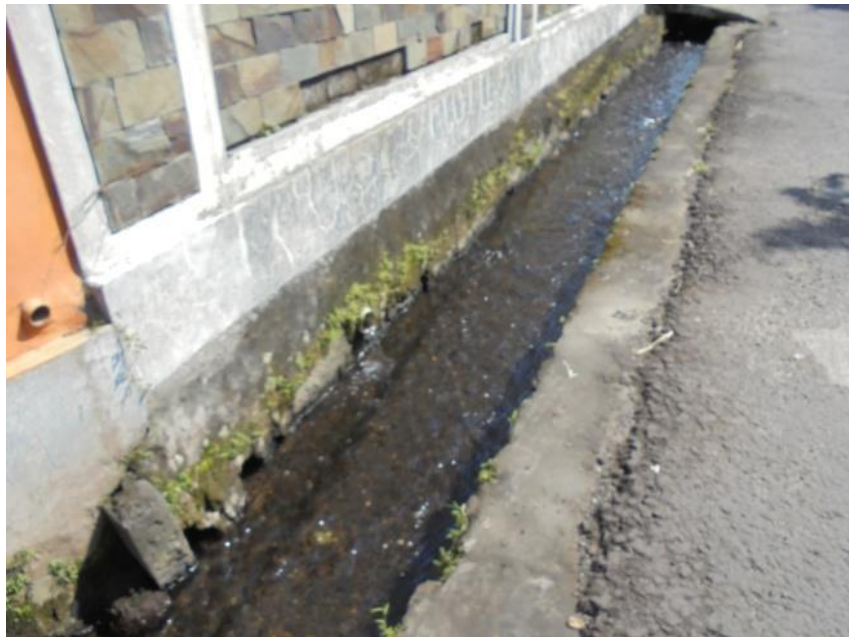
Foto 2. Kondisi Saluran Drainase di Kecamatan Ngaglik
