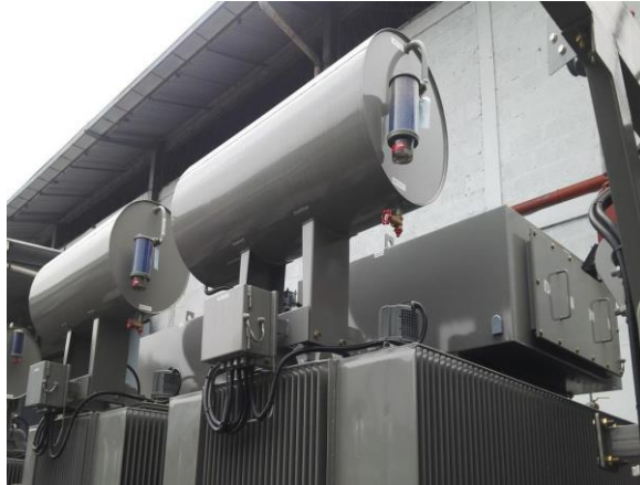
Gambar 2.10. Konservator pada transformator (Sumber: PT. TRAFONDO PRIMA PERKASA)
