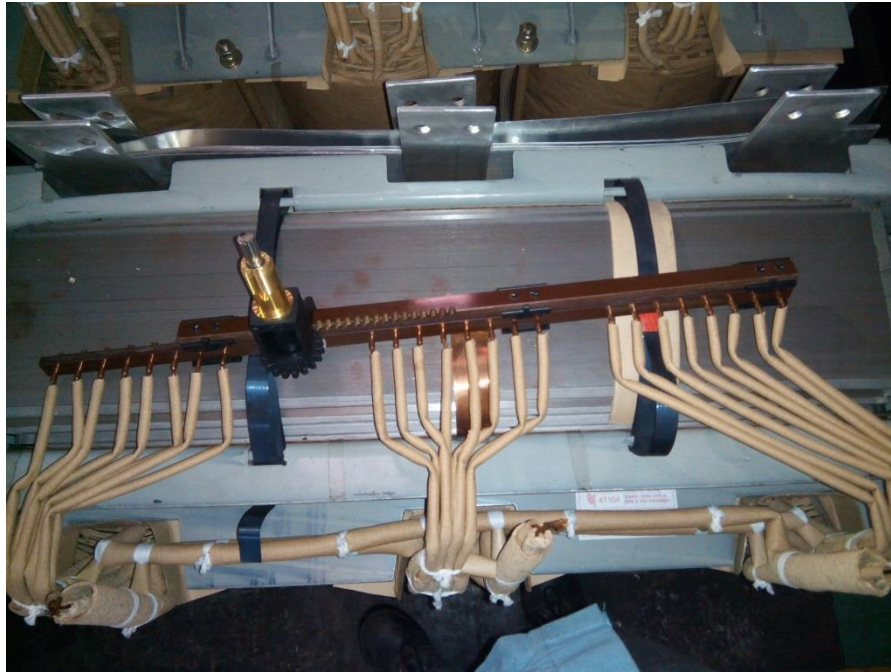
Gambar 4.2. Core-coil Transformator 250 kVA yg telah Terkoneksi
