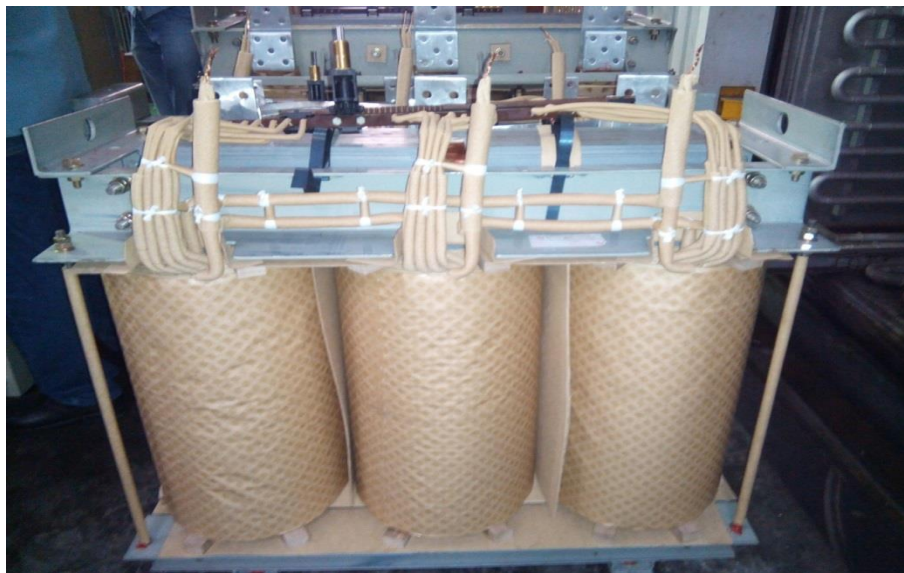
Gambar 4.1. Core-coil Transformator 250 kVA yg telah Terkoneksi
