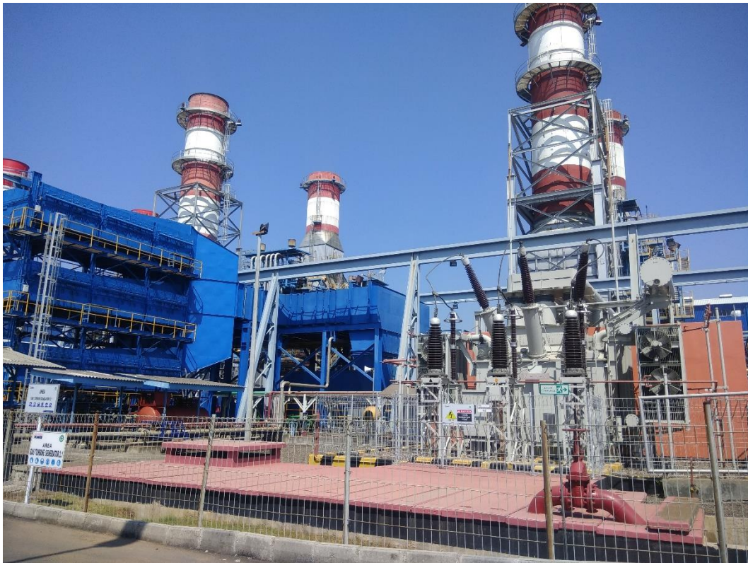
Gambar 4. 1 Unit GTG 2.2 Tampak Depan
