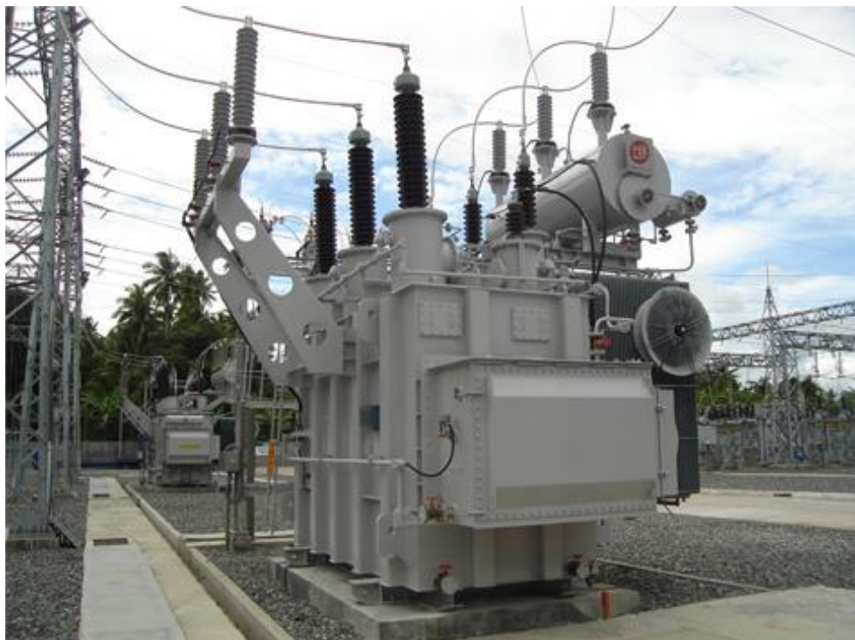
Gambar 2.2 Transformator Daya Gardu Induk 150 kV Kentungan
