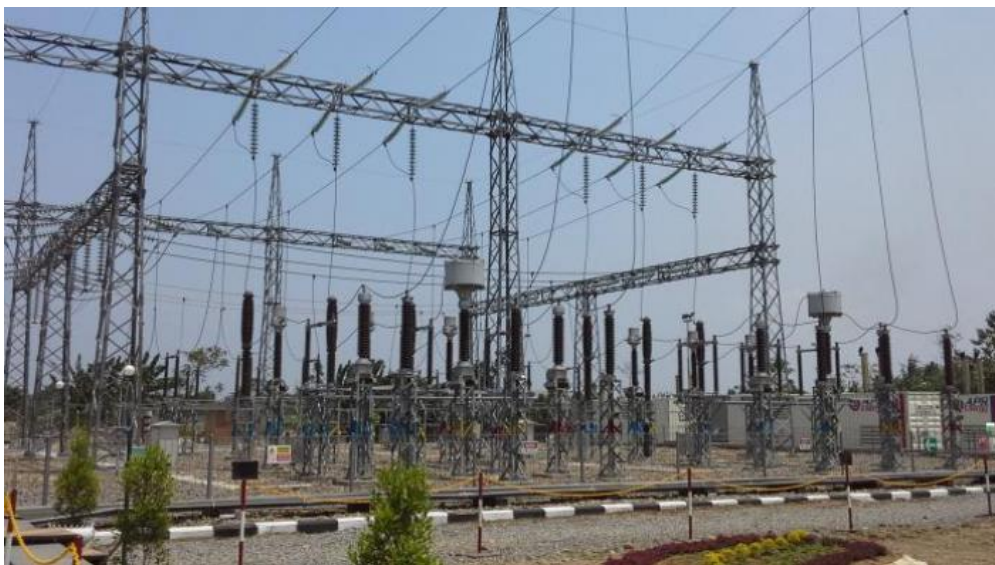
Gambar 2.1 Gardu Induk 150 kV Kentungan
