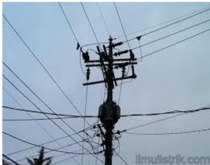
Gambar 2.3 Saluran Kabel Udara Tegangan Menengah
