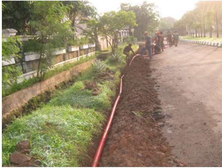
Gambar 2.4 Saluran Kabel Tegangan Menengah
