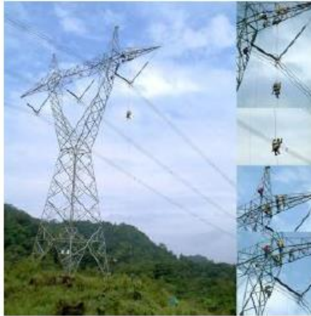
Gambar 2.1 Saluran Udara Tegangan Ekstra Tinggi
