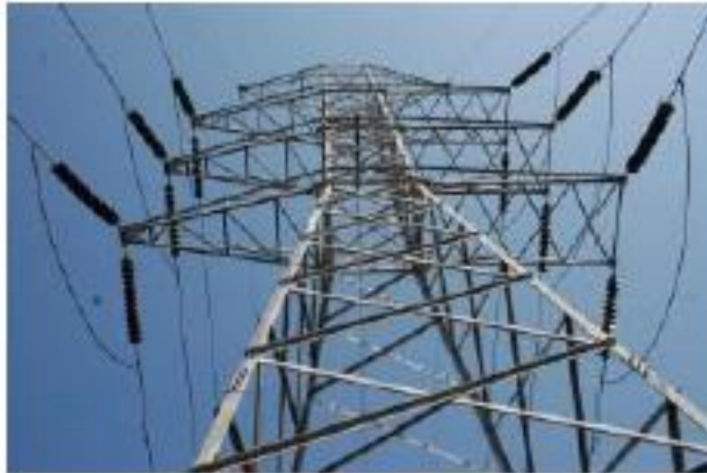
Gambar 2.2 Saluran Udara Tegangan Tinggi
