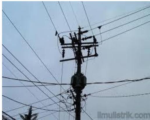
Gambar 2.1 Saluran Kabel Udara Tegangan
