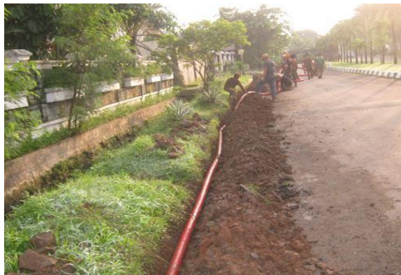
Gambar 2.2 Saluran Kabel Tegangan Menengah
