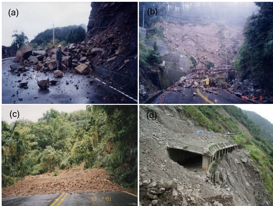
Gambar 1.5 Kejadian longsor pada ruas jalan T-18 dan T-21 di Taiwan: (a) longsor tipe runtuh batuan, (b) longsor gelincir, (c) aliran debris, dan (d) runtuh debris batuan (Liao dkk., 2006).
