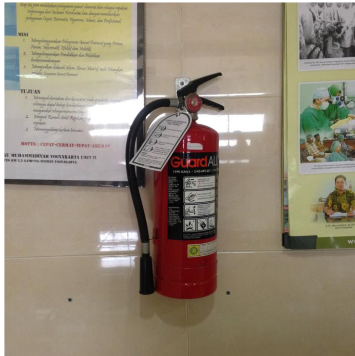
Gambar 12 Alat pemadam kebakaran IGD RS PKU Muhammadiyah Yogyakarta Unit II
