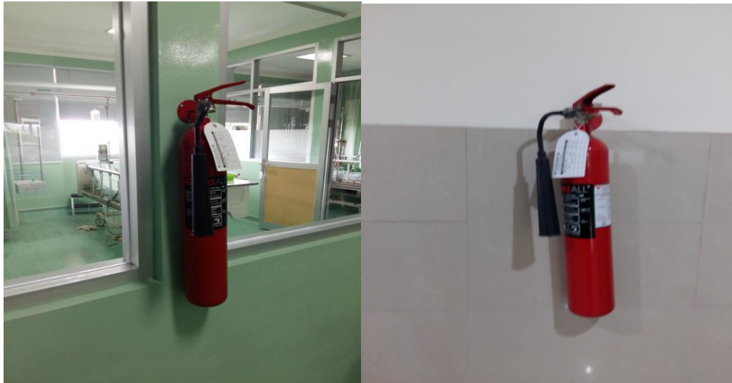
Gambar 4.13 Alat Pemadam Kebakaran
